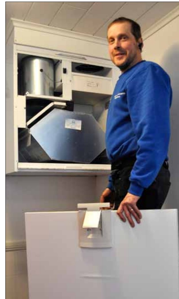
VAK:n ison maalämpökeskuksen asennuksesta perushanan vaihtoon, ja kaikkea mahdollista siltä väliltä. Kaskihovi ja VAK ovat esimerkkejä pitkäaikaisesta yhteistyöstä.
